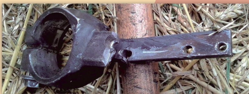
Рис. 8. Изгиб силового привода открытия крыши бункера
